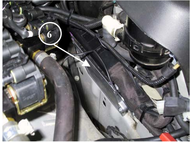
6) Centralina elettronica del gas
